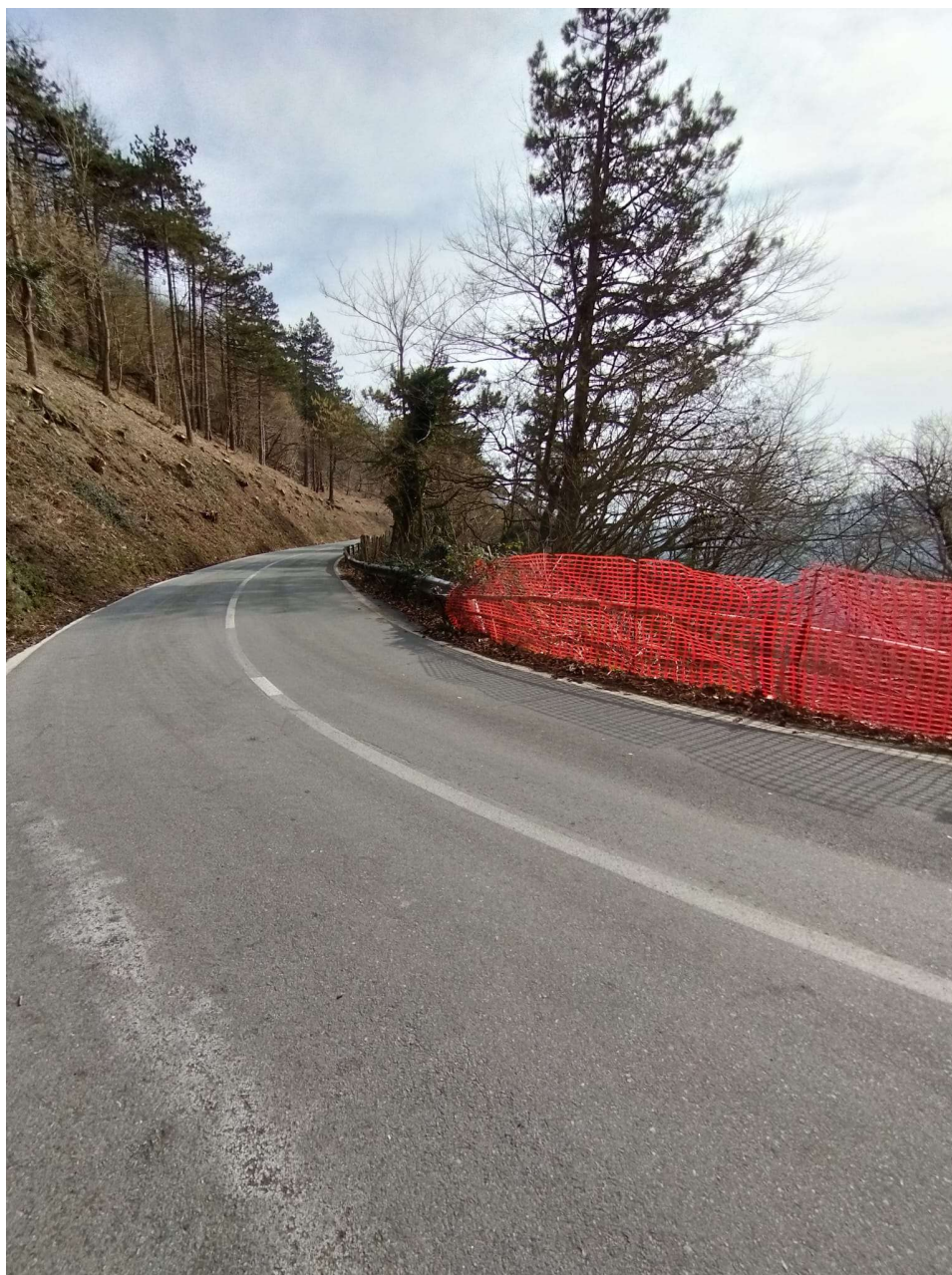
Figura 2 – Cordolo di valle esistente SP 73 km 1+130
